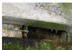
Cavité dans la pile du pont à Pouzac.
