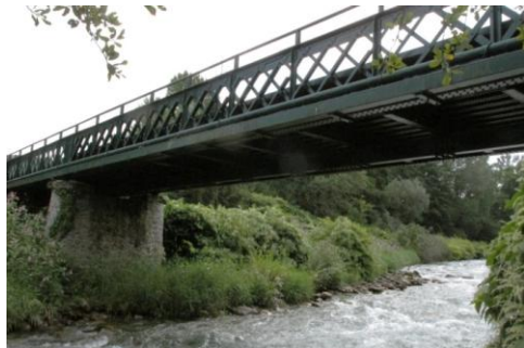
Pont à structure métallique entre Trébons et Ordizan (65) : non favorable
