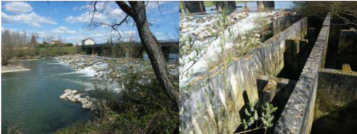
Photos 55 et 56 : Seuil de Saint-Sever et sa passe à poissons par bassins
