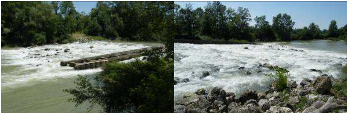
Photo 61 : Seuil rive gauche avec la passe à poissons
